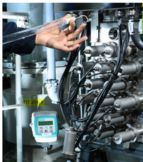
Figura 8. Detalle del sistema Pureballast.
