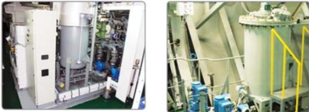
Figura 3. Unidad de electrolisis e inyección de la solución de tiosulfato.
