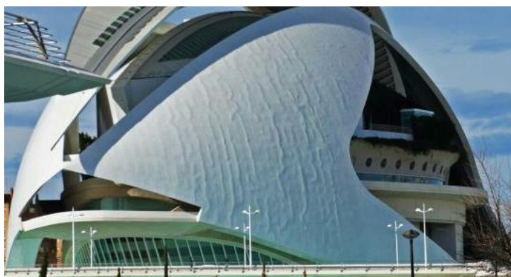
Ilustración 3-1. Fachada dañada de la Ciudad de las Artes y Las Ciencias (fuente: El País)
