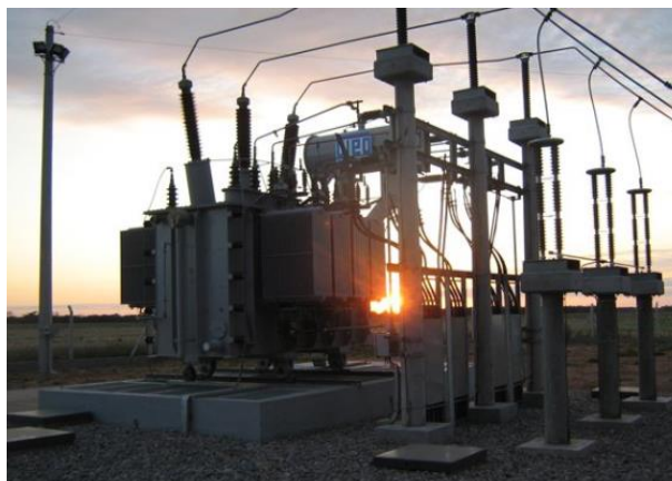
Figura 54: Transformador de alta tensión utilizado en las subestaciones eléctricas [32]
