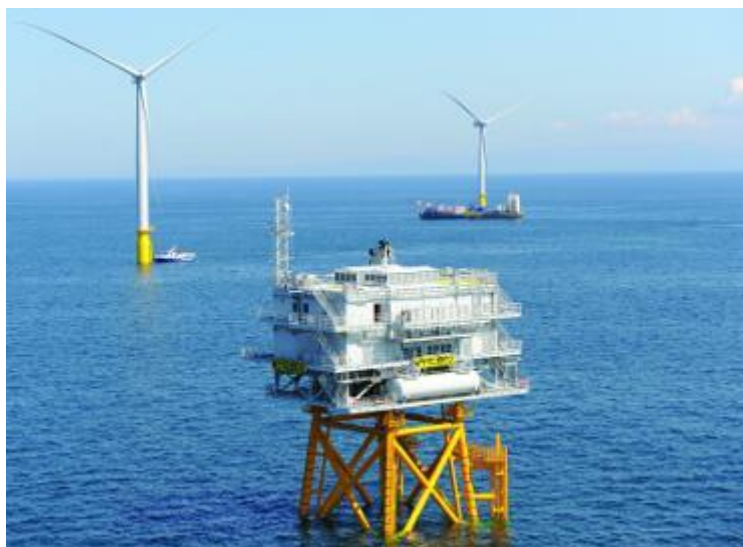
Figura 56: Subestación offshore parque eólico “Walney Phase 2” [33]
