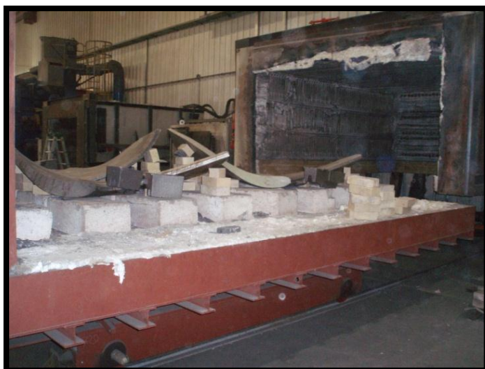
Figura 29: Horno de tratamiento térmico.
