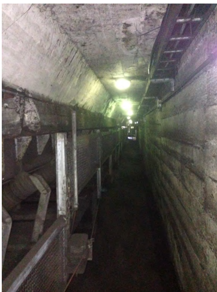
Galería transitable por la que transcurre el transportador C4. Autor "Samuel Povedano García"
