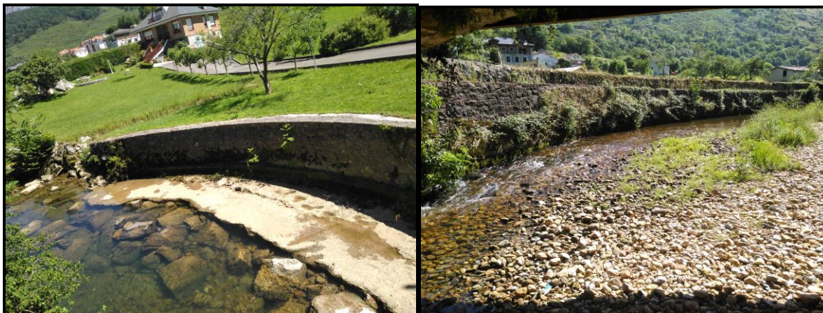
Fotografía 1: Escolleras para controlar el avance del agua en el centro urbano. Imagen propia tomada el 5/6/2017
