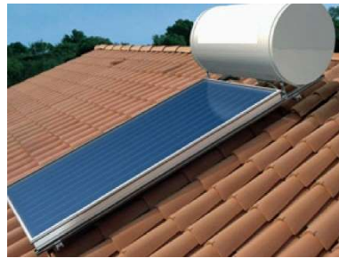
8. "Panel solar térmico instalado con depósito de acumulación" Fuente: energiasrenovablesinfo.com
