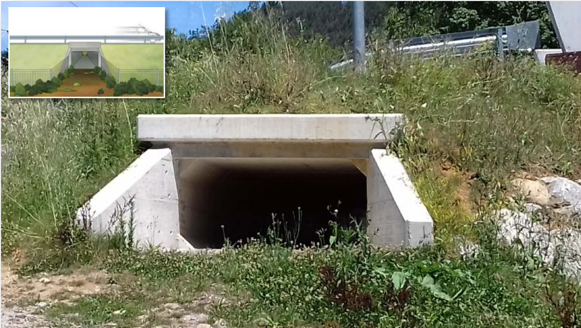
Figura 47. Paso inferior para pequeños vertebrados en la carretera local CA-711 de Helguera, Cantabria (Fuente: elaboración propia).
