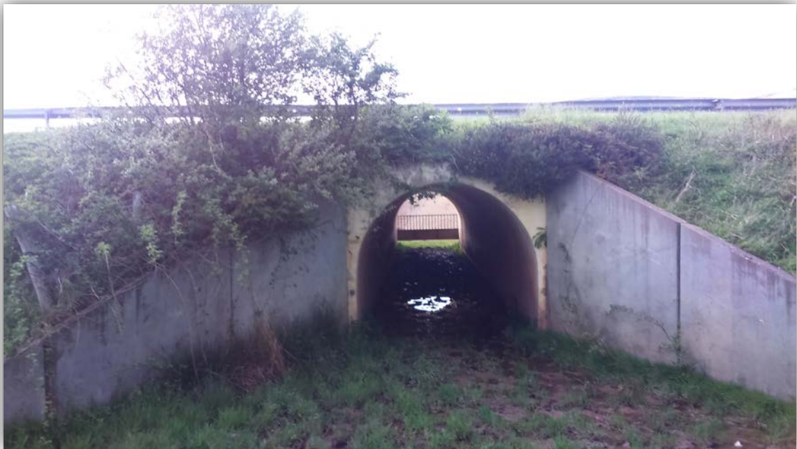
Figura 74. Paso inferior con portilla para fauna en la carretera CA-171 (Fuente: elaboración propia).
