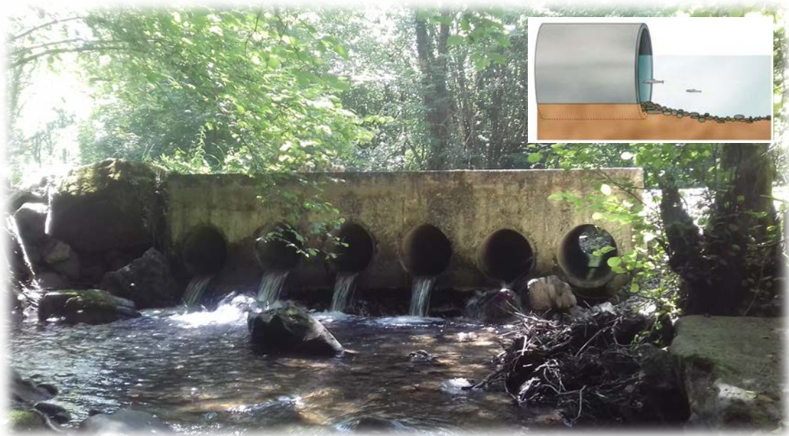
Figura 50. Drenajes adaptados para peces en el camino de acceso al viaducto de Montabliz, Cantabria (Fuente: elaboración propia).
