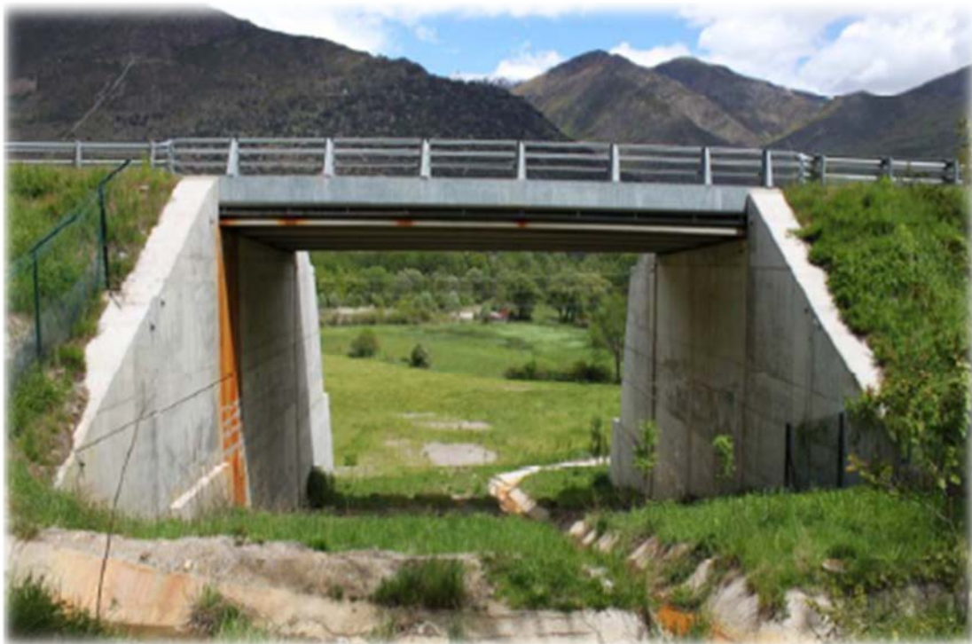
Figura 42. Paso inferior específico para la fauna en Cataluña. (Fuente: Documento Inventari d'estructures de connectivitat a la xarxa viària catalana).
