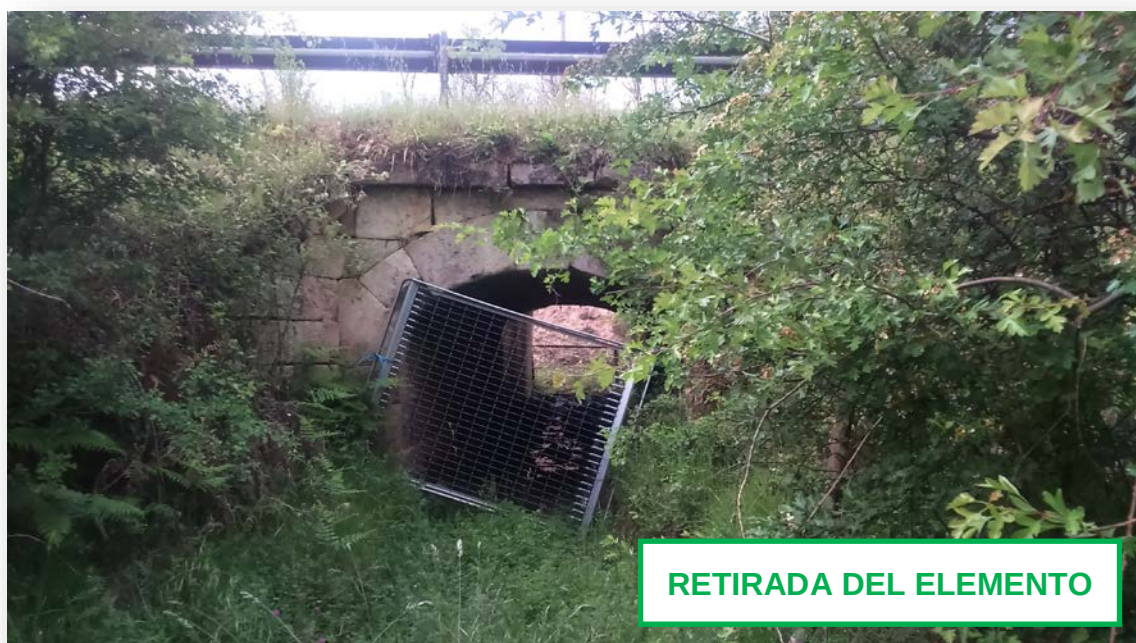
Figura 89. Drenaje rectangular de la carretera CA-272 en Valderredible (Fuente: elaboración propia).
