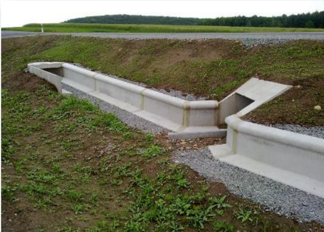
Figura 54. Estructura guía de hormigón con paso de anfibios en Alemania. (Fuente: https://www.maibach.com/leiteinrichtung-aus-beton.html ).
