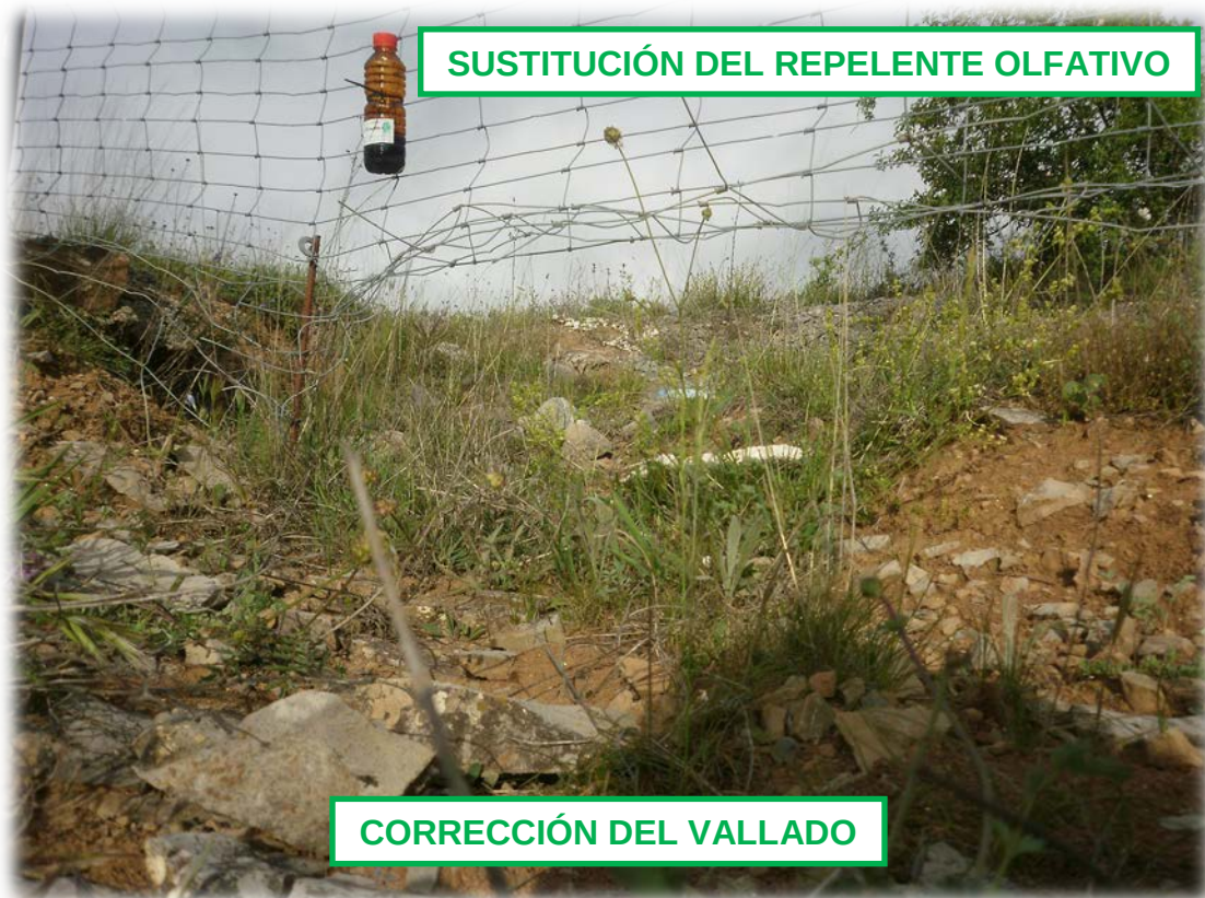
Figura 99. Daños en vallado con repelente olfativo, A-67 Valdeprado del Río (Fuente: elaboración propia).
