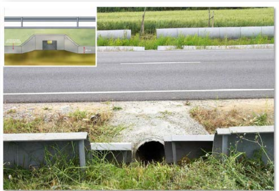
Figura 52. Vista de la estructura de guía instalada en una batería de pasos para anfibios de la carretera GIV-6216. (Fuente: Documento Inventari d'estructures de connectivitat a la xarxa viària catalana).
