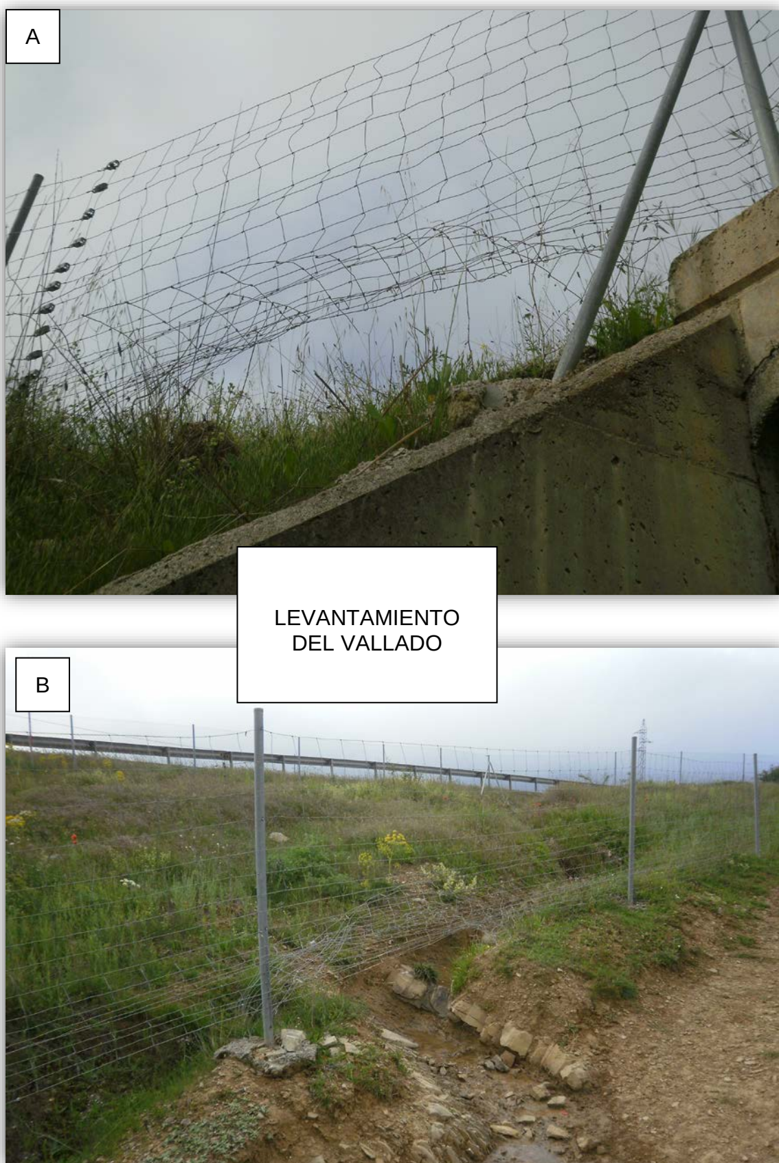
Figura 93. Desperfectos en el vallado perimetral de la A-67, Valdeprado del Río (Fuente: elaboración propia).
