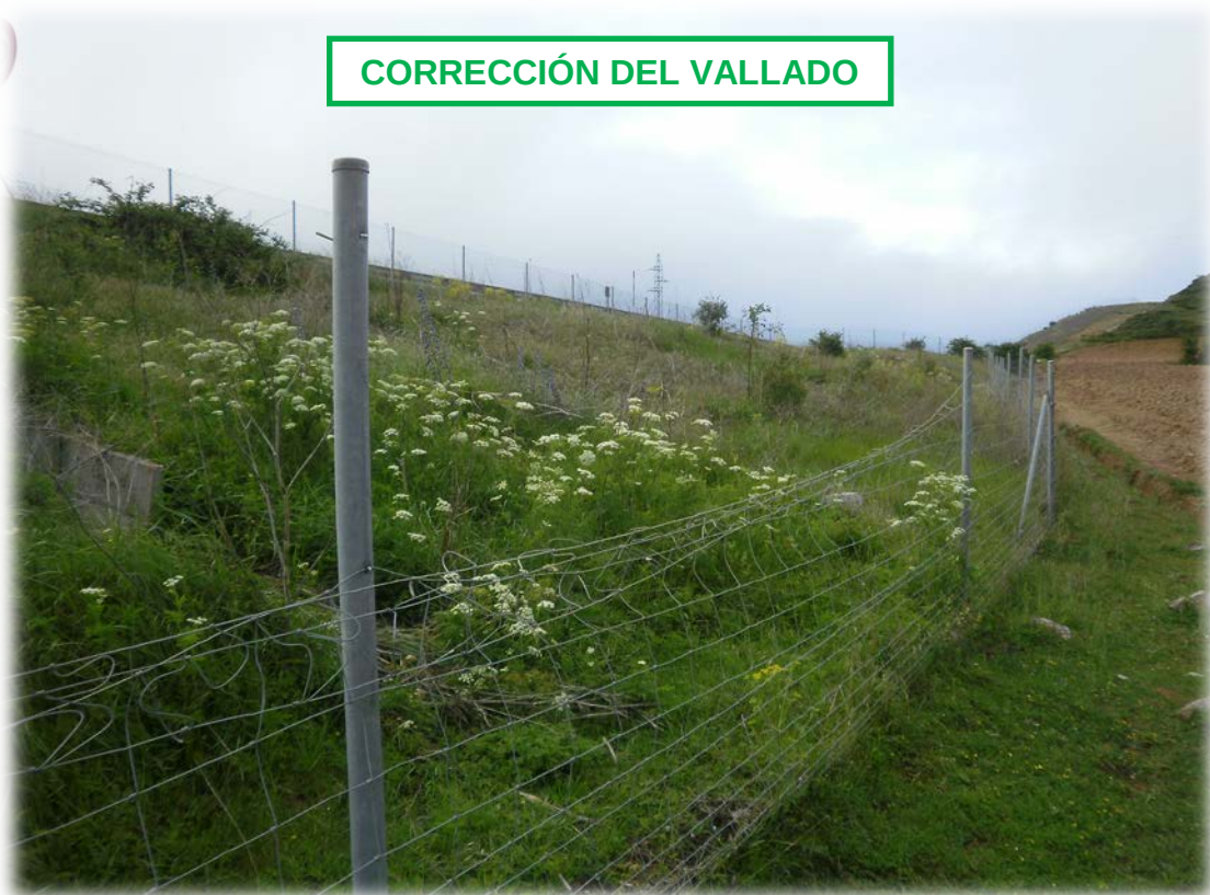
Figura 98. Daños en el vallado perimetral de la autovía A-67, Valdeprado del Río. Fácilmente franqueable por corzos (Fuente: elaboración propia).
