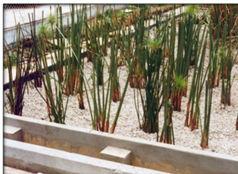
Humedales de flujo subsuperficial
