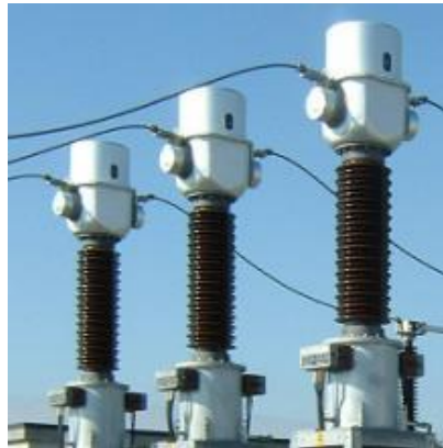
Figura 2.8. Transformadores combinados. (Fuente: [14]).
