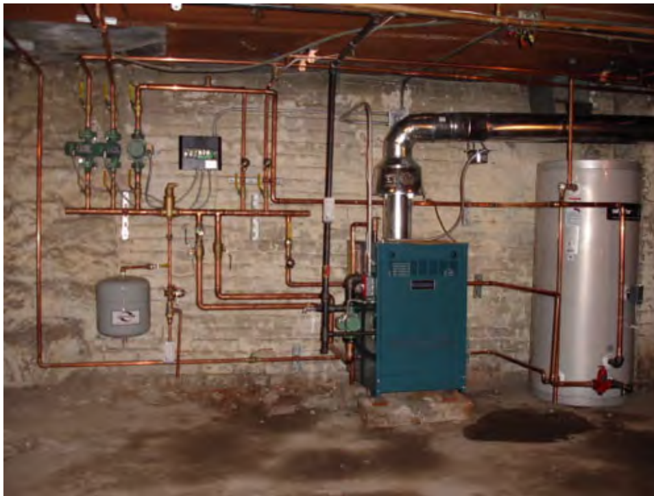
Ilustración 35: Instalación de una caldera de gasoil producto derivado del petróleo. Fuente encoser.
