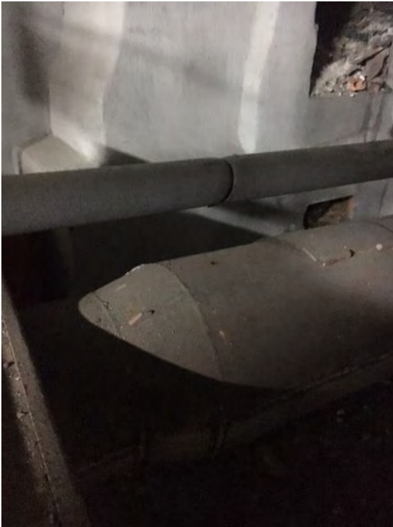
Ilustración 14: Tubo que sale de la caldera dirección al serpentín. Fuente: Elaboración propia
