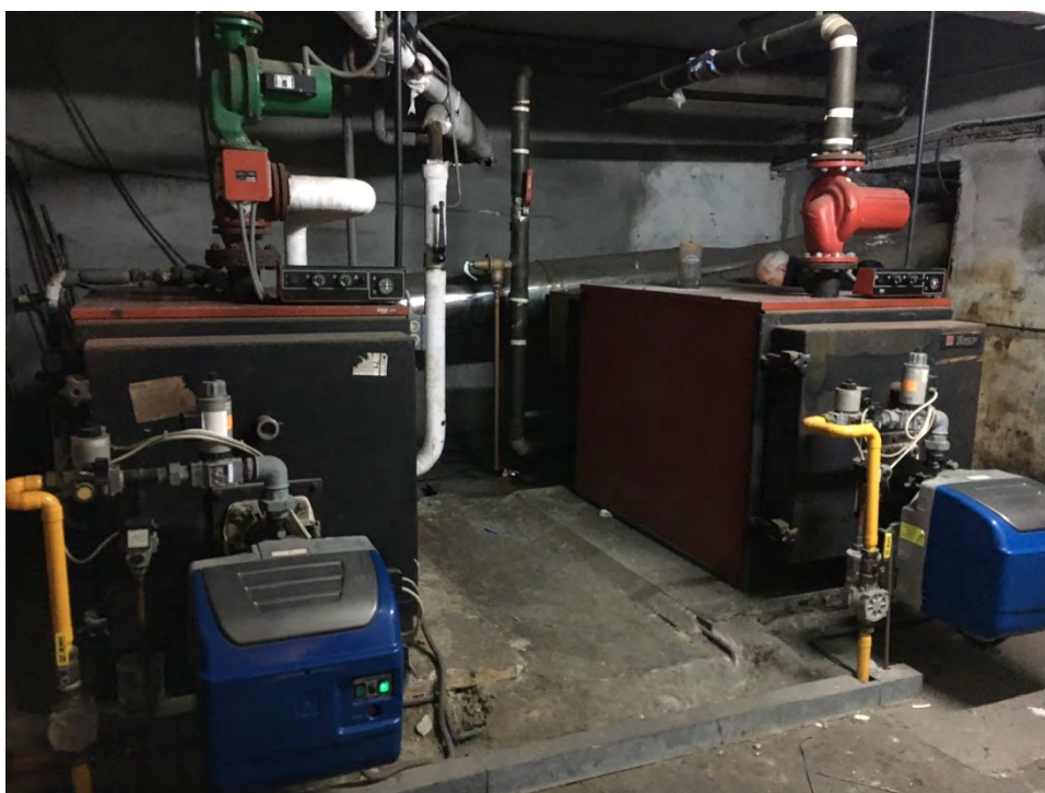
Ilustración 2: Imagen de la sala de calderas actual. Fuente: Elaboración propia.
