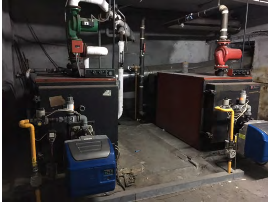
Ilustración 9: Imagen general de la sala de calderas. Fuente: Elaboración propia.
