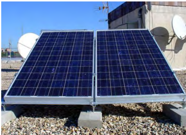
Ilustración 8: Captador solar plano. Fuente: caloryfrio.
