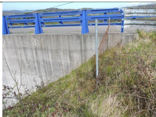
Figura 221.- Deficiencias en el vallado (foto: propia).
