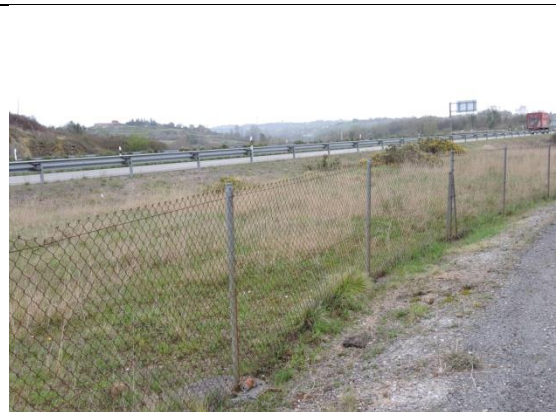
Figura 174.- Zona de mayores deficiencias en el vallado (foto: propia).
