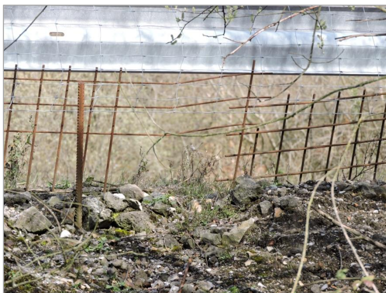
Figura 273.- Deterioro en el vallado de la AP-66 con arreglo “artesanal” (foto: propia).
