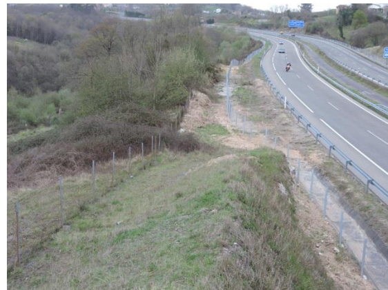
Figura 172.- Vallado reforzado (foto: propia).
