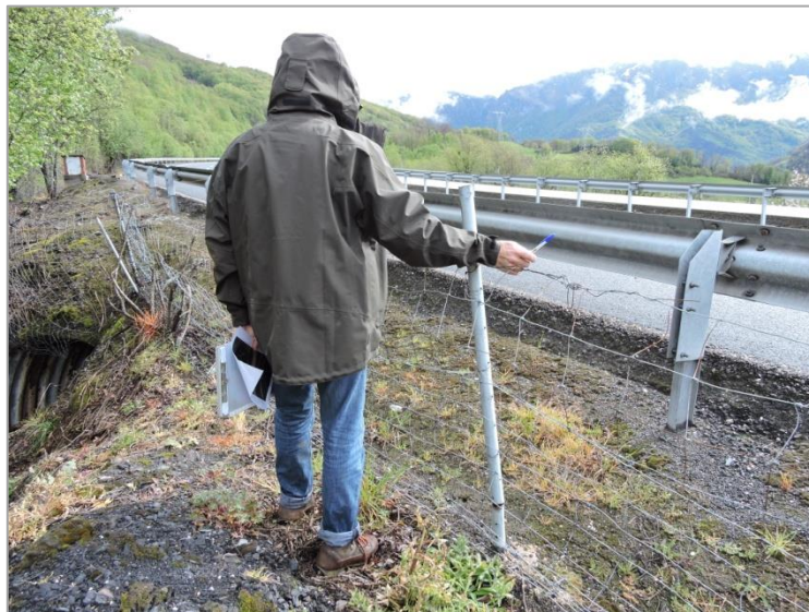
Figura 274.- Vallado deteriorado en la AP-66 insuficiente para impedir el acceso de los osos a la calzada (foto: propia).
