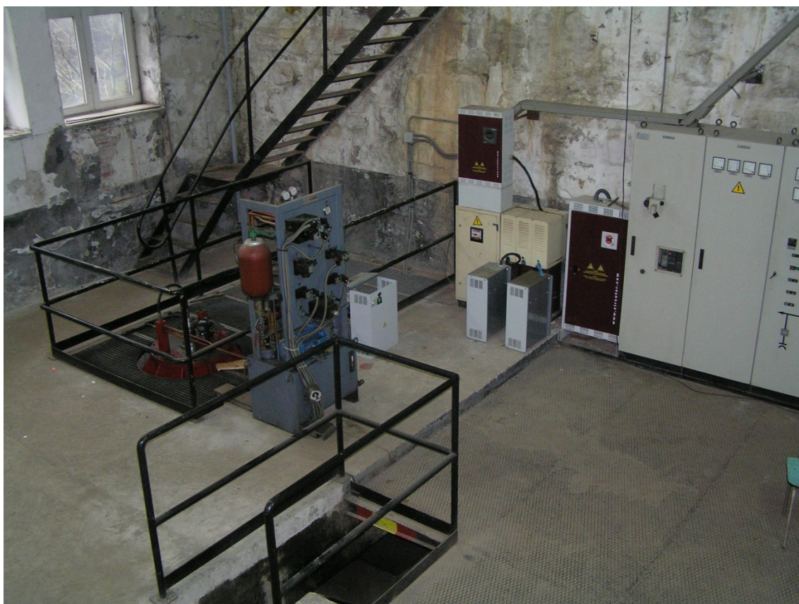
Figura 16. Vista completa del sistema generador
