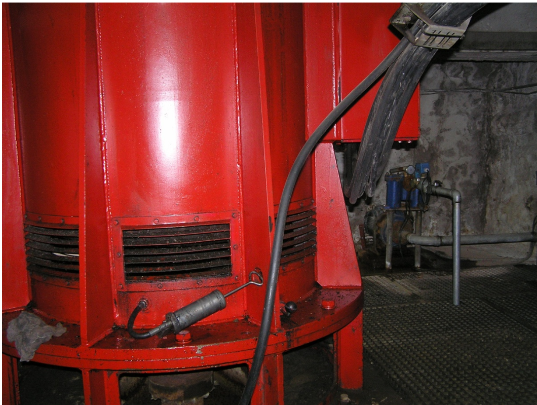
Figura 1. Generador de inducción de la central
