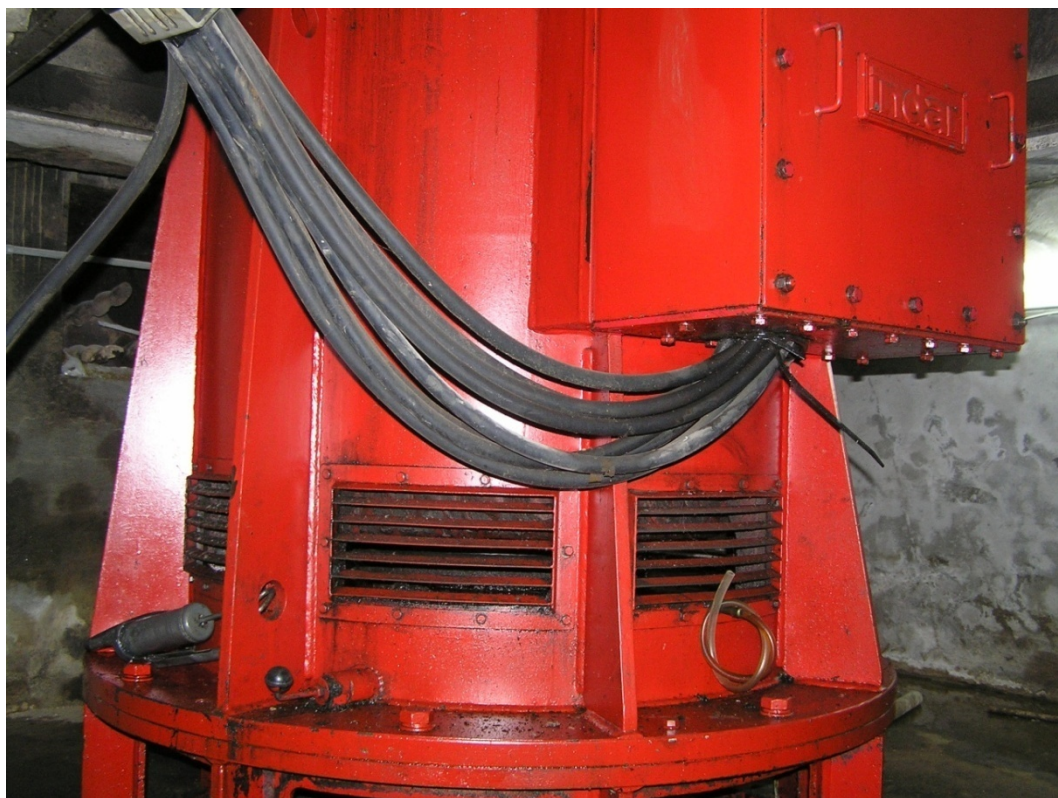
Figura 15. Vista desde abajo del generador
