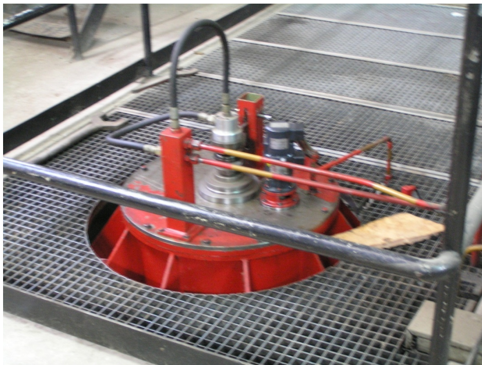
Figura 14. Vista desde arriba del generador
